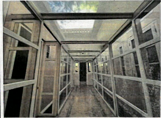
5.2 舊教學樓廁所對出陽光蓬及鋁框玻璃滲漏水
